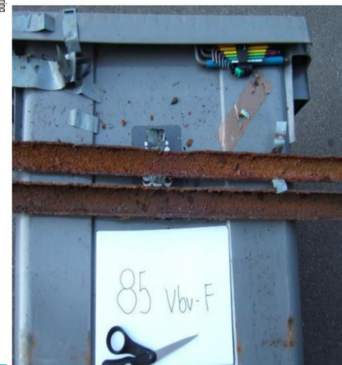
Rørprøve udtaget på kælderledning for varmt vand i nr. 85 med kun 5-8% afsætning og <5% tæring.
